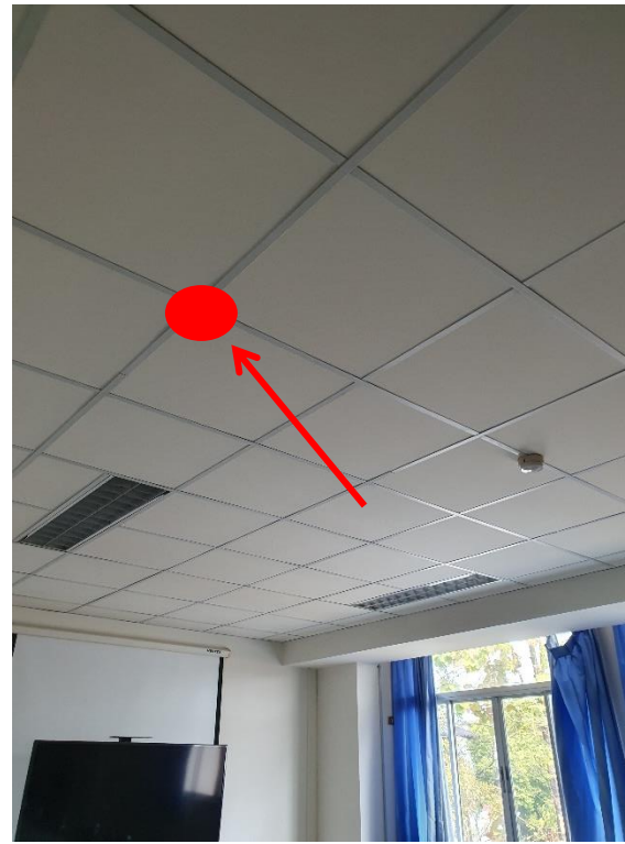
รูปถ่ายแสดงจุดติดตั้ง AP
