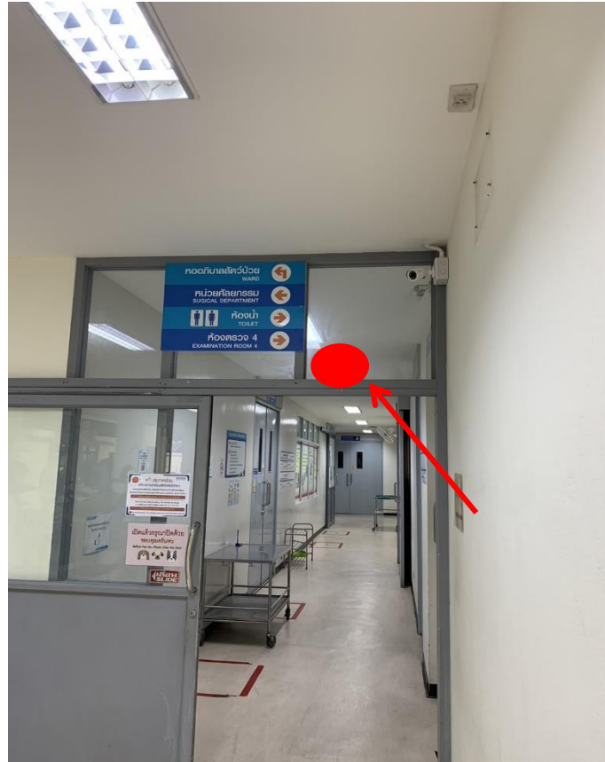
รูปถ่ายแสดงจุดติดตั้ง AP
