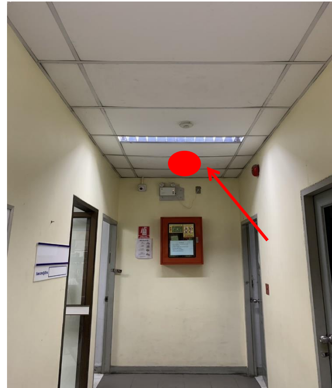
รูปถ่ายแสดงจุดติดตั้ง AP
