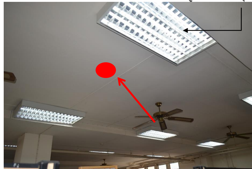
รูปถ่ายแสดงจุดติดตั้ง AP
