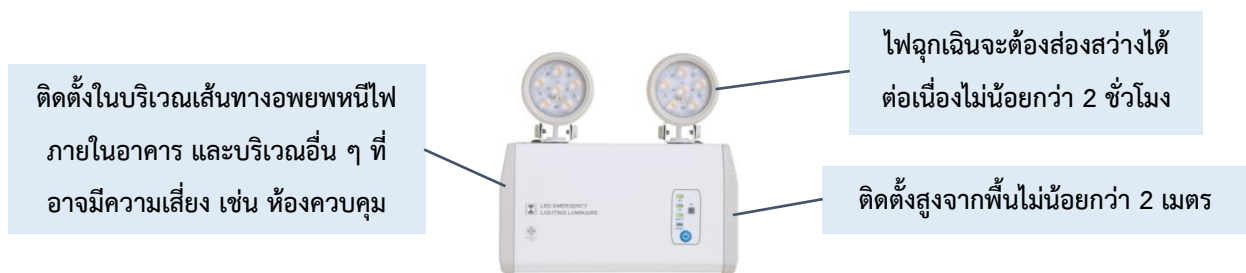
รูป 16 ไฟฉุกเฉิน
